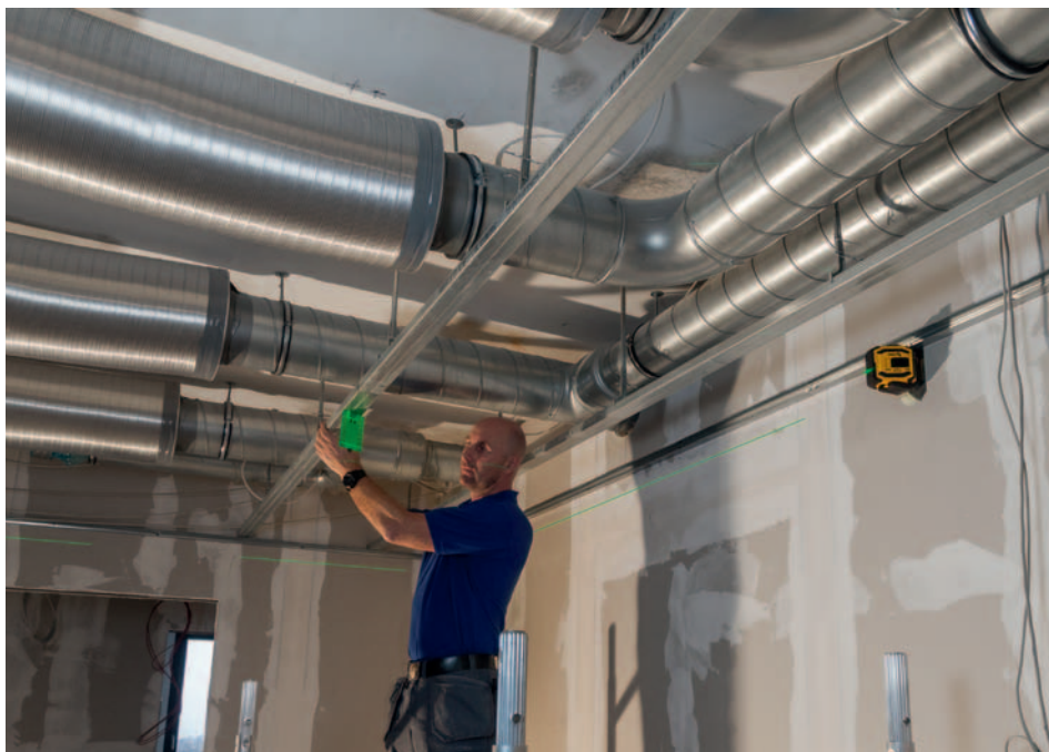
Im Trockenbau – Decken abhängen, Zwischen- und Trennwände positionieren, U-Profile montieren und Layout vom Boden an die Decke übertragen.
