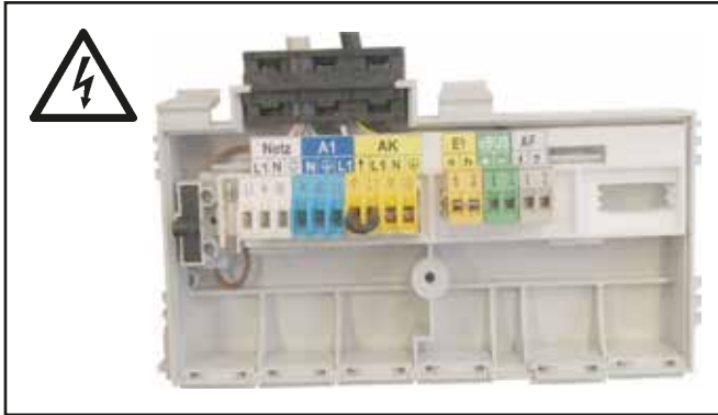
Bild: Klemmkasten, Gefahr durch elektrische Spannung
