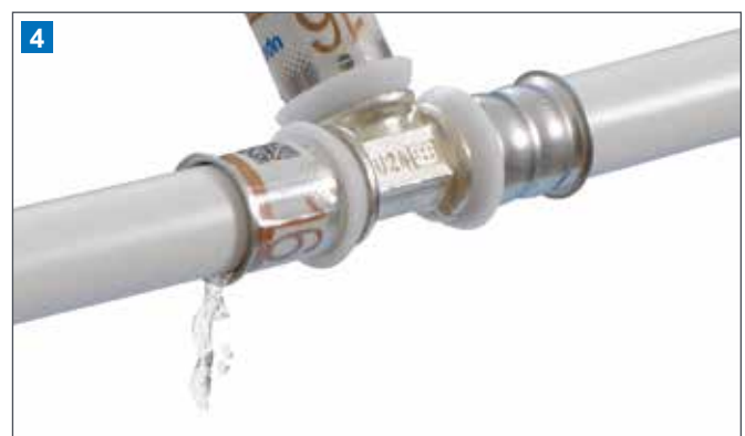
4 Unverpresste Verbindungen werden bei der Dichtheitsprüfung durch die unverpresst-undicht-Funktion sicher als undicht erkannt. Ein unverpresstes Fitting fällt zudem durch die noch vorhandene Indikatorfolie auf der Edelstahl-Presshülse deutlich auf.
