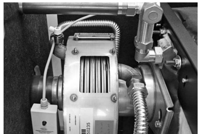
Abb. 88: Reinigungsöffnung des RWT
