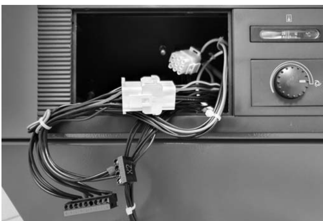
Abb. 104: Getrennte Anschlussstecker für den Regler.
