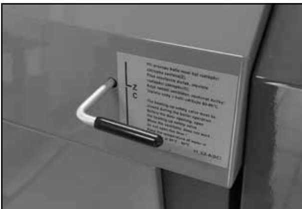
Anheizklappe geschlossen – Zugstange eingesteckt
