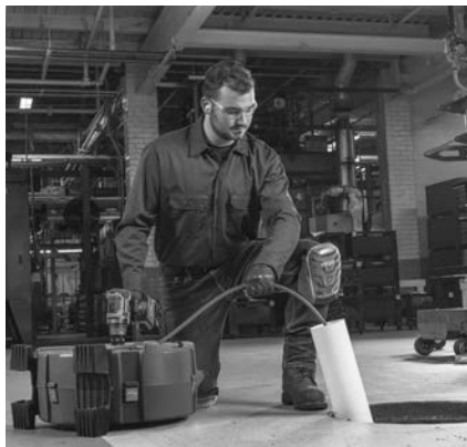
Slika 5 - Primjer produžetka otvora odvoda do udaljenosti od 3' od izlaza sajle iz stroja
