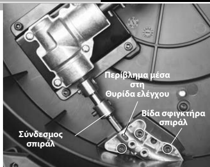
Εικόνα 16 – Αλλαγή του συγκροτήματος σπирάλ
