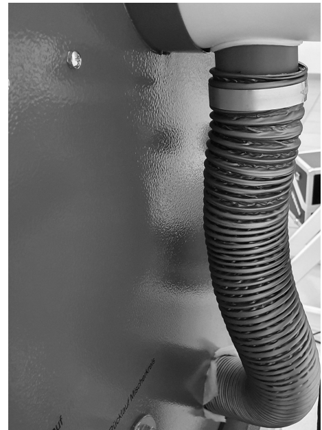
Abb./Fig. 11: Zuluftschlauch am Kesselabgasanschluss
