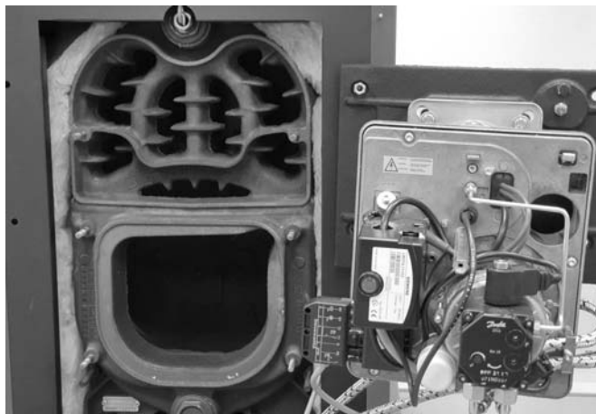
Abb. 85: Geöffneter Kessel mit Brenner in Serviceposition.
