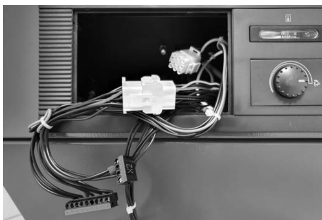
Abb. 104: Getrennte Anschlussstecker für den Regler.
