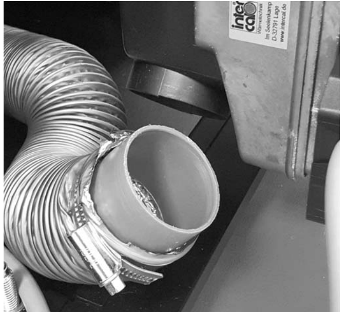
Abb. 13: Zuluftschlauch mit 50 mm Anschluss-Stück
