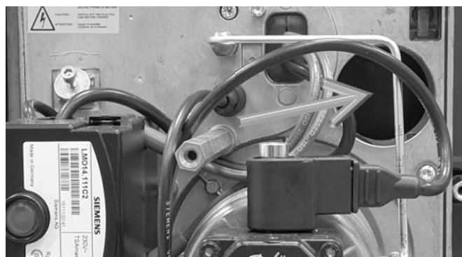
Abb. 9: Luft-Ansaugöffnung des Blau-Brenners BNR
