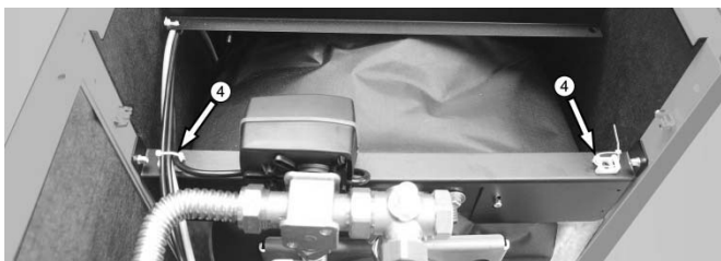
Abb. 25: Kabelführungen an der Querstrebe ④
