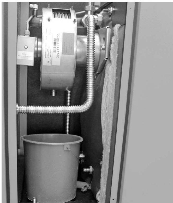
Abb. 89: Zur Reinigung vorbereiteter RWT
