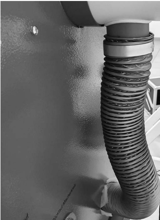
Abb. 12: Zuluftschlauch am Kesselabgasanschluss
