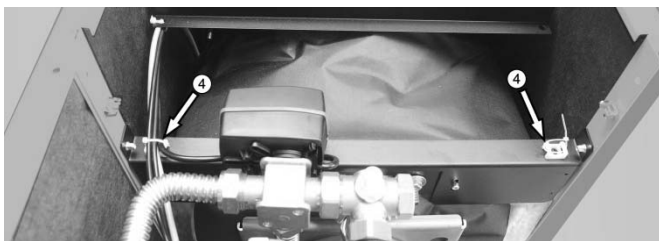
Abb. 25: Kabelführungen an der Querstrebe ④
