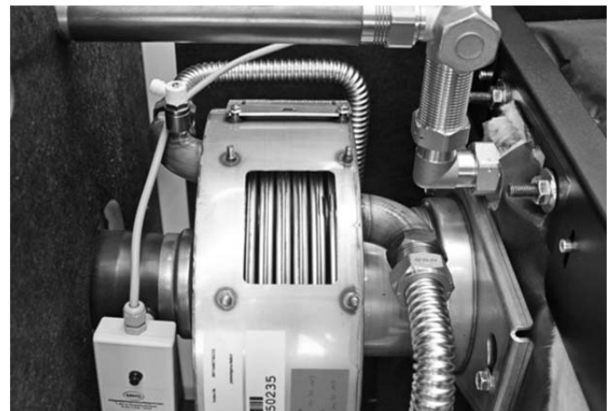
Abb. 88: Reinigungsöffnung des RWT
