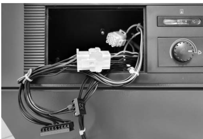
Abb. 104: Getrennte Anschlussstecker für den Regler.
