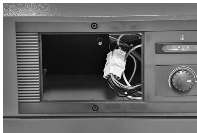
Abb. 29: Offener Reglerschacht mit Steckverbindung für den Regler-Kabelbaum.
