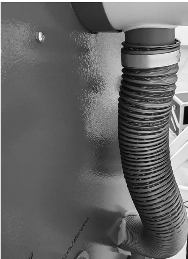
Abb. 12: Zuluftschlauch am Kesselabgasanschluss
