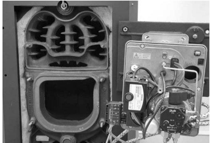
Abb. 85: Geöffneter Kessel mit Brenner in Serviceposition.
