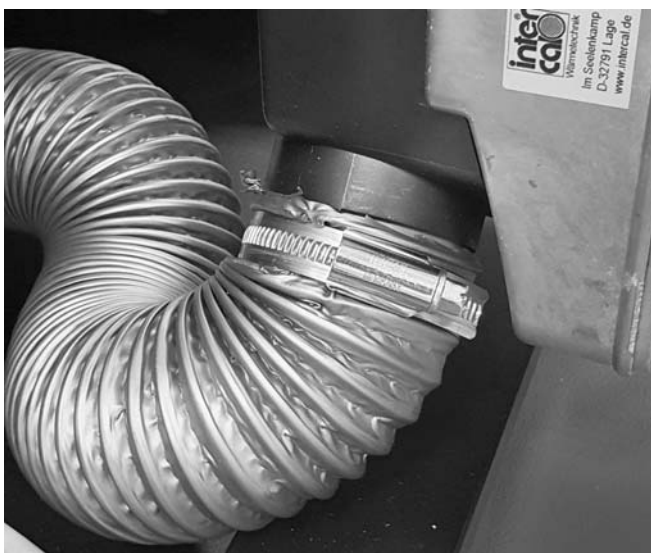
Abb. 14: Zuluftschlauch mit 50 mm Anschluss-Stück
