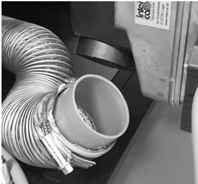
Abb. 13: Zuluftschlauch mit 50 mm Anschluss-Stück
