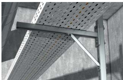
Kabeltray auf Konsolenkonstruktion
