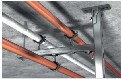
Konsolenkonstruktion mit Schienen
