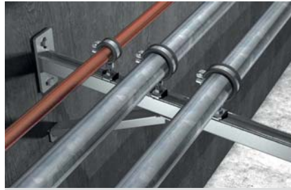
Rohrbefestigung entlang der Wand
