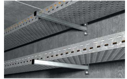
Kabeltrasse auf Auslegerkonsolen
