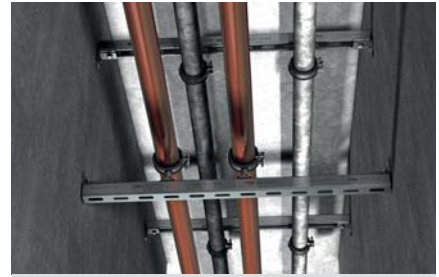
Rohrbefestigung im Flurbereich
