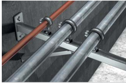
Rohrbefestigung entlang der Wand
