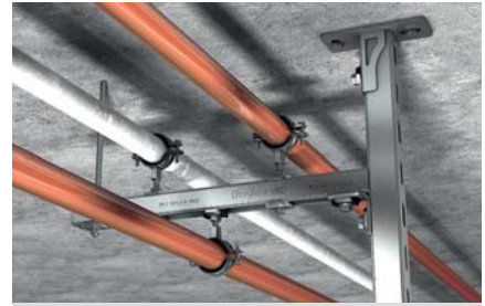
Konsolenkonstruktion mit Schienen
