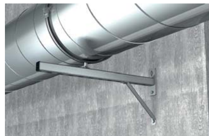
Lüftungsrohrbefestigung an der Wand
